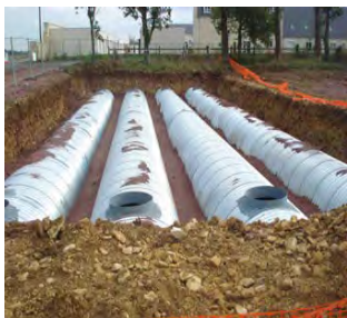
BASSINS DE RETENTION
