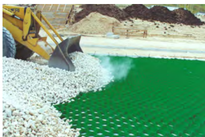
CELLULE DE REMPLISSAGE
